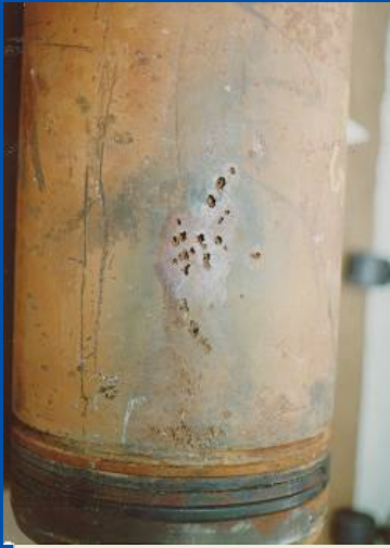
Dommages par cavitation
